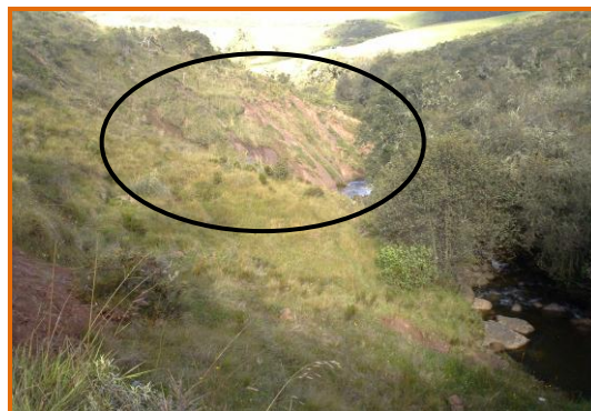
Foto No. 25 Procesos erosivos y de deslizamientos en la cuenca del Río Mugroso, Vereda la Unión Usme
