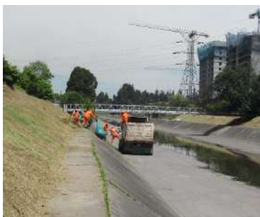
Fotografía 34: Se evidencia proceso de desarrollo urbano sobre el margen norte del canal a la altura de la 72c y 72d los cuales están realizando intervención en la estructura del canal para la instalación de una red hídrica
