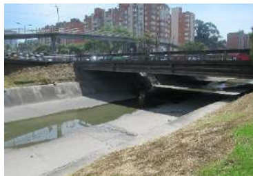
Fotografía 1. Tramo 1 - Inicio de canal en la localidad de Fonitbon sobre la Av. 68.
