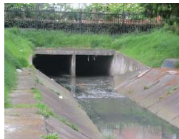
Fotografía 10. Entrega de las aguas al Box Culver que atraviesa la Av. Calle 24 y continua su flujo por el canal Oriental
