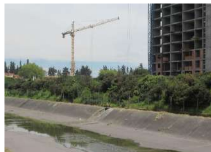
Fotografía 35: Fotografía 7: Se evidencia proceso de desarrollo urbano sobre el margen norte del canal a la altura de la 72c y 72d los cuales están realizando intervención en la estructura del canal para la instalación de una red hídrica
