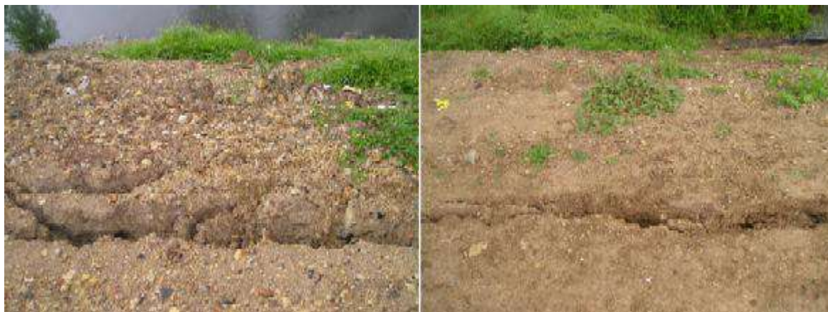
Figura VI-2. Agrietamiento y remoción en masa por infiltración del agua en los materiales arcillosos del Jarillón
